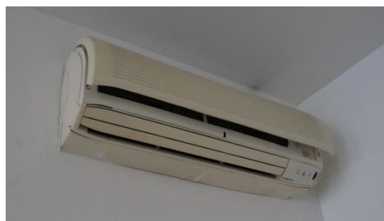
Figura 4.18 - Particolare del sistema di climatizzazione
