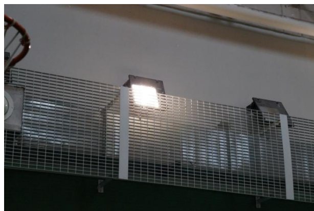
Figura 4.21 - Particolare dei corpi illuminanti ubicati in palestra
