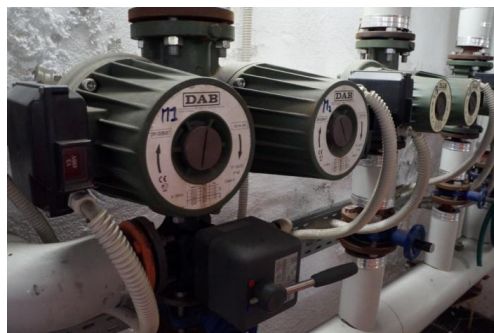
Figura 8.7 – Particolare pompe di circolazione
