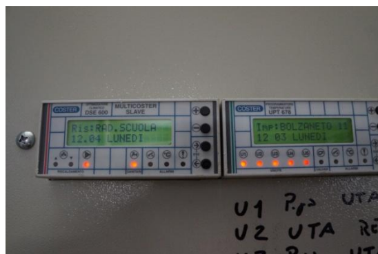
Figura 4.9 – Particolare della centralina di controllo all'interno della centrale termica
