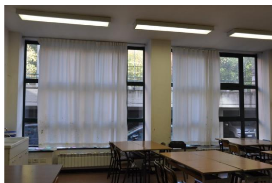
Figura 4.19 - Particolare dei corpi illuminanti ubicati nelle aule
