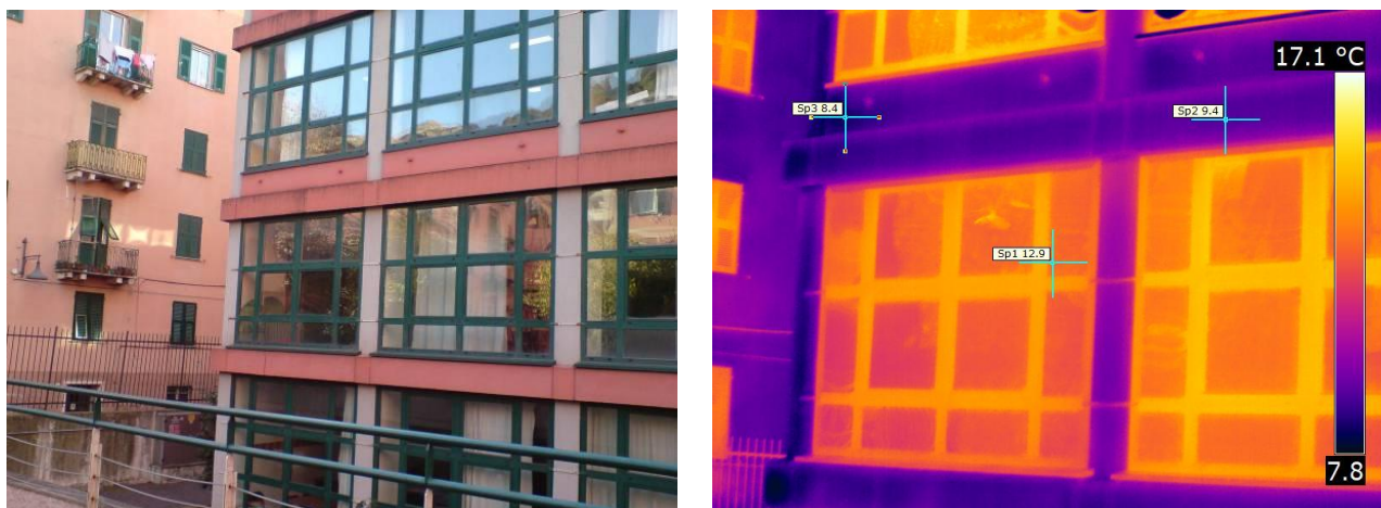
Figura 4.5 – Rilievo termografico dei serramenti al piano secondo e terzo sul fronte principale
